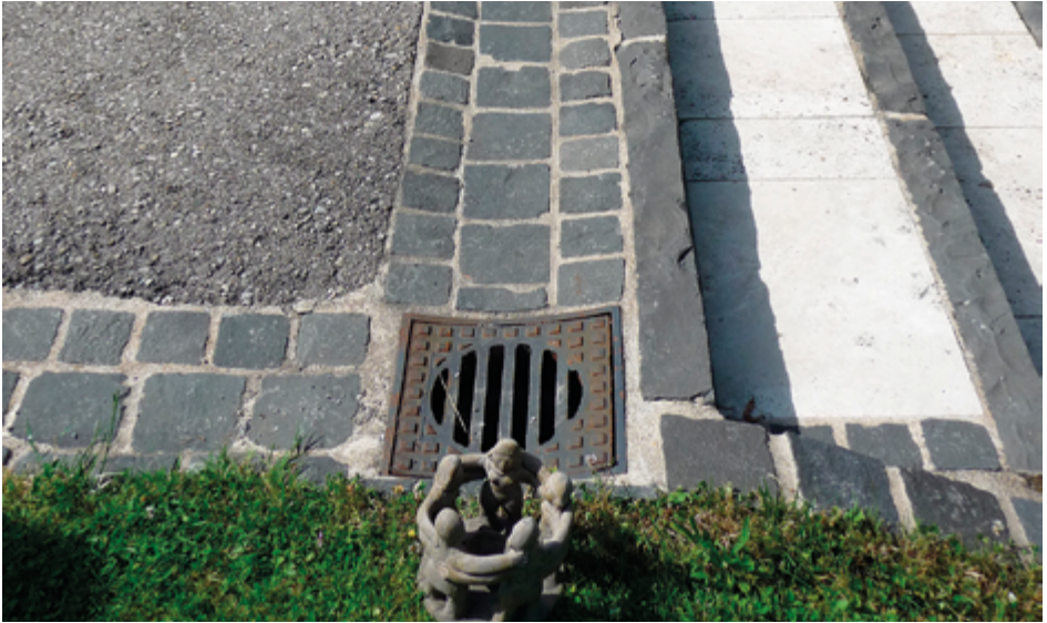
Abb. 90: Offene Mulden-Abflüsse und Aufkantung an einem Hof halten das Wasser vom Haus fern.
