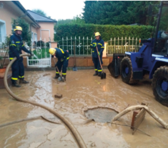
Abb. 23: Aufräumarbeiten nach einer Sturzflut in Sinsheim
